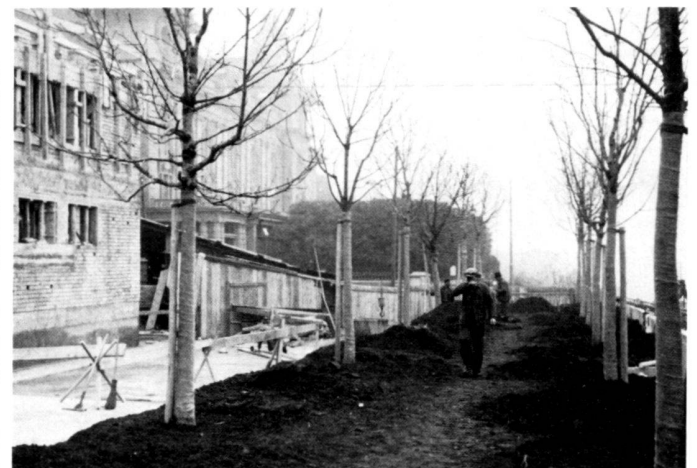
A gauche: Acheminement de la terre lors de la construction du jardin sur le toit du garage du Casino en 1936.
