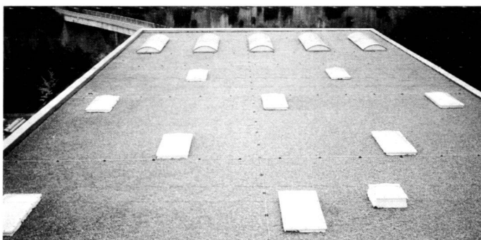
Unten links: Die Mehrheit der untersuchten Dachflächen zeigen ein trostloses Erscheinungsbild; Beispiel: Ascom, Bern.
