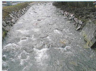
Aufgelöste, unstrukturierte Rampe, 2008.
