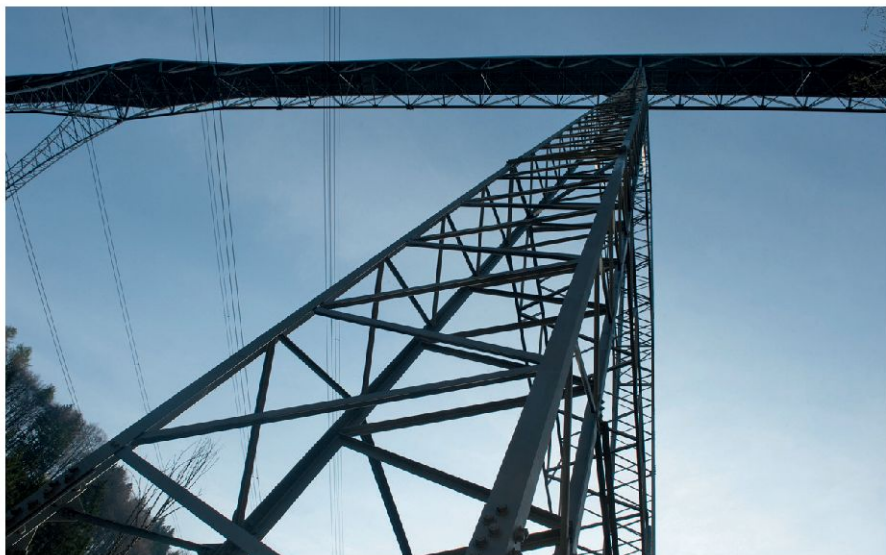
Die «Ganggelibrogg», die in fast 100 Metern Höhe St. Gallen-Haggen mit der Gemeinde Stein über das Sittertobel verbindet, wurde von Mai 2009 bis April 2010 umfassend saniert.
