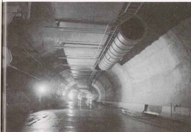
8 — Acceleratore da 57 kW disposto in calotta
