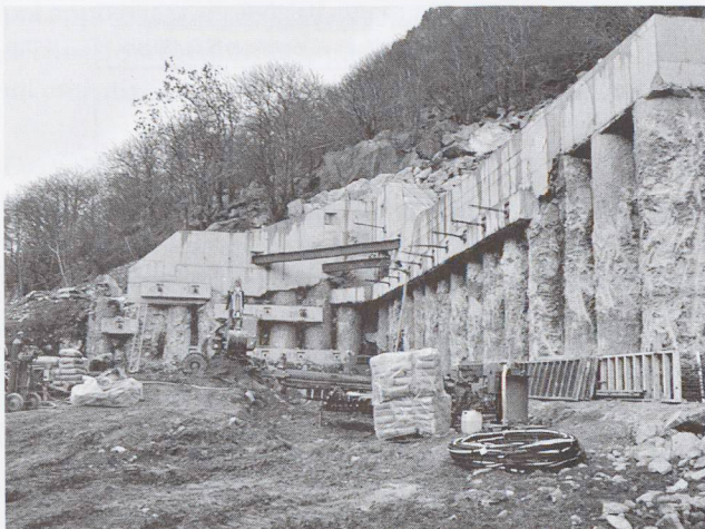
18 – Vista equivalente a metà scavo. Sulla destra c'è la parete di sostegno divisoria tra le canne ovest e est. È in perforazione e posa il secondo livello d'ancoraggio
