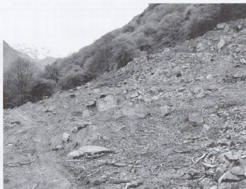
17 - Il disboscamento preliminare consente una valutazione realistica delle dimensioni dei blocchi costituenti il terreno di costruzione. I portali delle due canne ovest (a sinistra) debbono essere collocati circa al centro della fotografia
