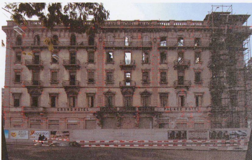
Facciata est, mappatura del degrado
