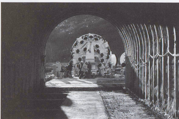
TBM davanti al portale pronta per essere tralata verso il fronte di scavo
