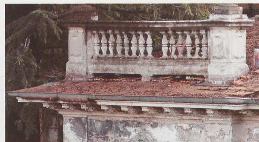
Fig. 1 – Lugano, ex Hotel Sport, stato demolito il 4 ottobre 2007. Dopo un periodo di forti piogge, nel quale la muratura sotto il tetto è stata sottoposta a prolungate infiltrazioni, la successiva evaporazione ha causato la formazione di efflorescenze saline (probabilmente di epsomite) sulla superficie.
