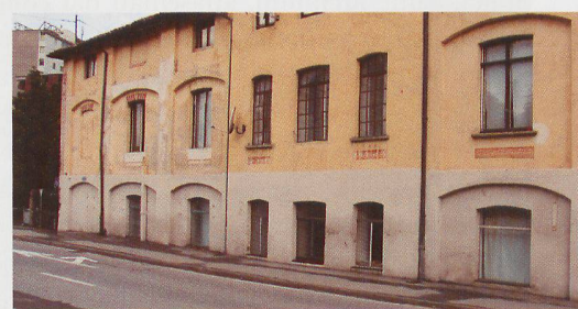
Fig. 4 – Pregassona, via Ceresio 46. Si vede bene la zona scura alla base della facciata, dovuta all'umidità di risalita capillare.
