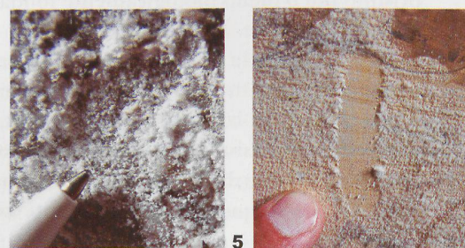
Fig. 5 – Dettaglio, con i danni visibili sopra l'intonaco a base di malta cementizia.
