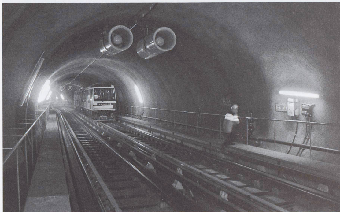
Fig. 6 - La tratta Formi-Vennes durante le prove incendio. Sulla destra è visibile una postazione di soccorso con segnaletica, telefono, estintore e idrante.
