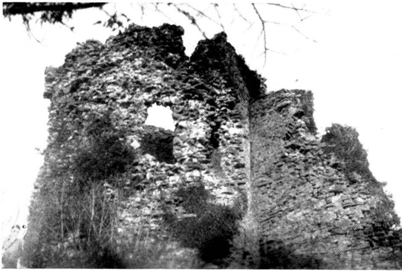
Der sehr gefährdete Westturm, der noch gesichert werden sollte.
