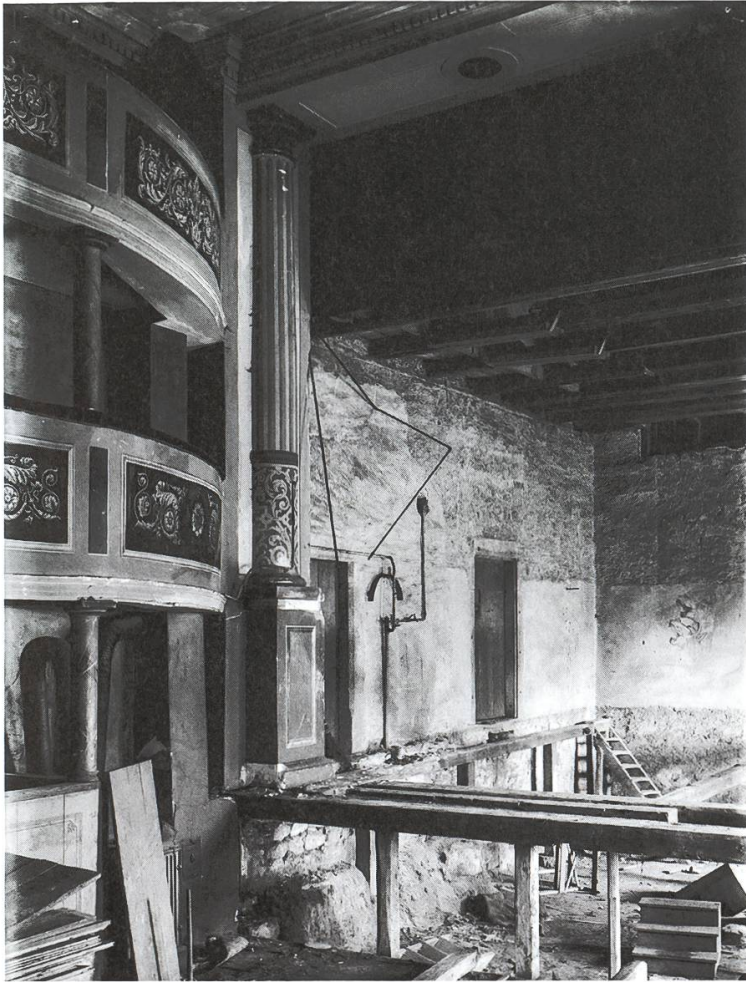
9 Umbauarbeiten im Innern des alten Stadttheaters, August 1918 (Foto: Historisches Museum Baden, Fotohaus Zipser, StAB Q.12.1.1273).
