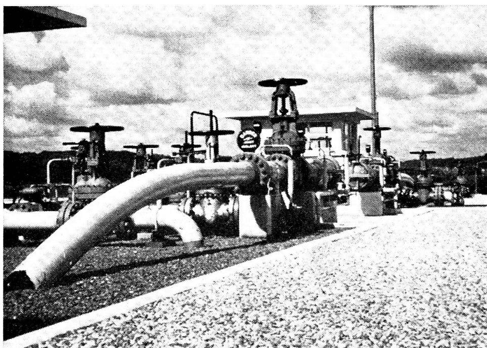
Pumpstation einer Pipeline (Photo Esso Schweiz)
