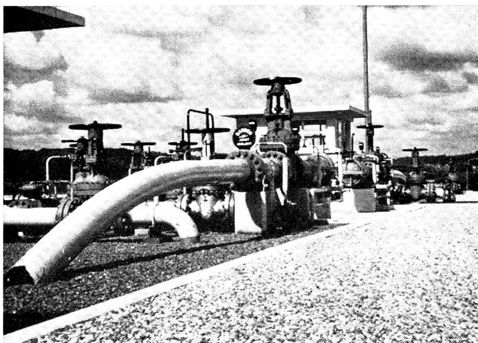
Pumpstation einer Pipeline (Photo Esso Schweiz)
