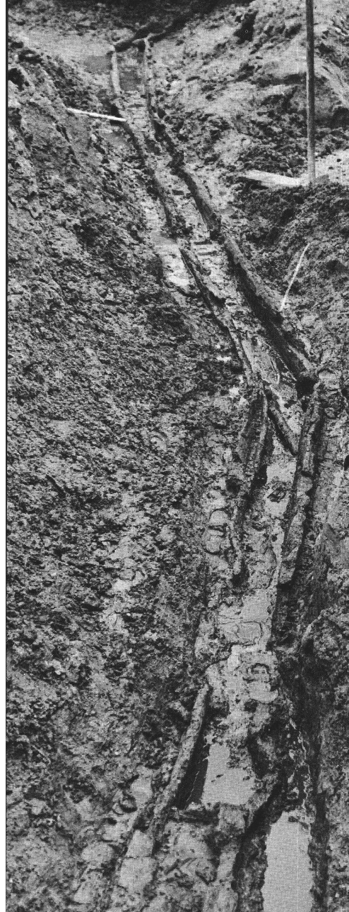
◀ Abb. 6 Die Abwasserleitung aus Holz während der Freilegung. Blick von Norden. La canalisation en bois pendant les fouilles. Il canale di acqua di rifiuto durante lo scavo.
