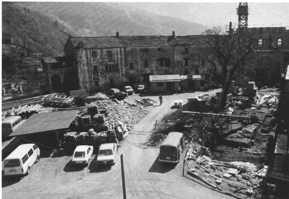
fig. 3 Veduta generale del cantiere di restauro; a destra l'area esplorata durante il 1985. Blick auf die Grabung 1985. Vue générale du chantier de restauration; à droite la surface explorée en 1985.
