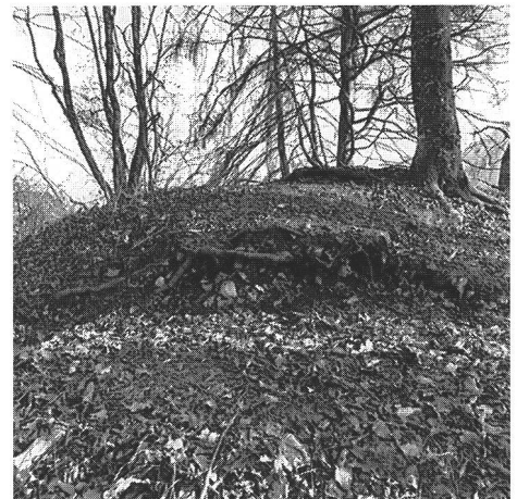
Abb. 5 Der heutige Fusspfad verletzt den oberen Teil des Walkkörpers (Abb. 6,4). Im »Profil« erkennt man gebrochenes und gelesenes Steinmaterial der Trockenmauer. Foto B. Redha. Le chemin pédestre actuel empiète sur la partie supérieure du rempart (fig. 6,4). Il est possible de reconnaître des pierres brisées et ramassées appartenant au mur en pierres sèches. Il sentiero odierno ha intaccato la parte superiore del terrapieno (fig. 6,4). La sezione longitudinale mostra materiale litico frammentato del muro a secco.
