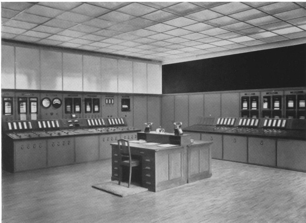
Kommandoraum des Betriebsgebäudes Innertkirchen.
