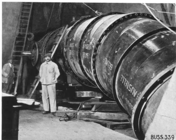
Apparatechamber des Druckschachtes Gelmersee-Handeck.
