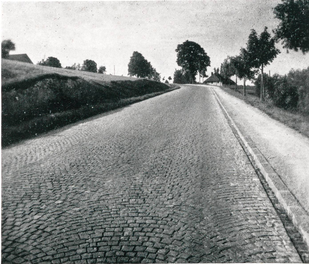
Steile Partie auf der Nordrampe der „Vue des Alpes“, ausgeführt von der Stuaag mit schweizerischen Kalksandsteinen.
