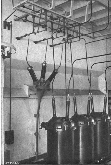
Fig. 19. Kabelendverschluss im Unterwerk Drahtzug.
