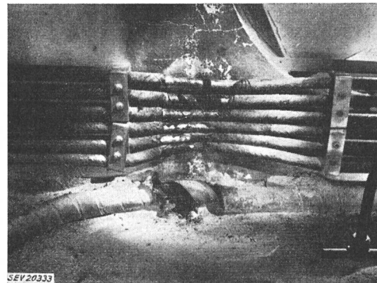
Fig. 3 Details der zerstörten Kabel In Fig. 2 befinden sich die Kabel am linken Bildrand
