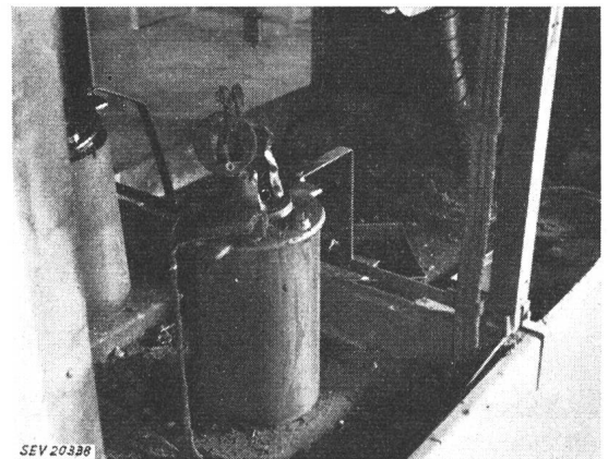
Fig. 8 Zerstörter 16-kV-Ölstromwandler im 1. Stock
