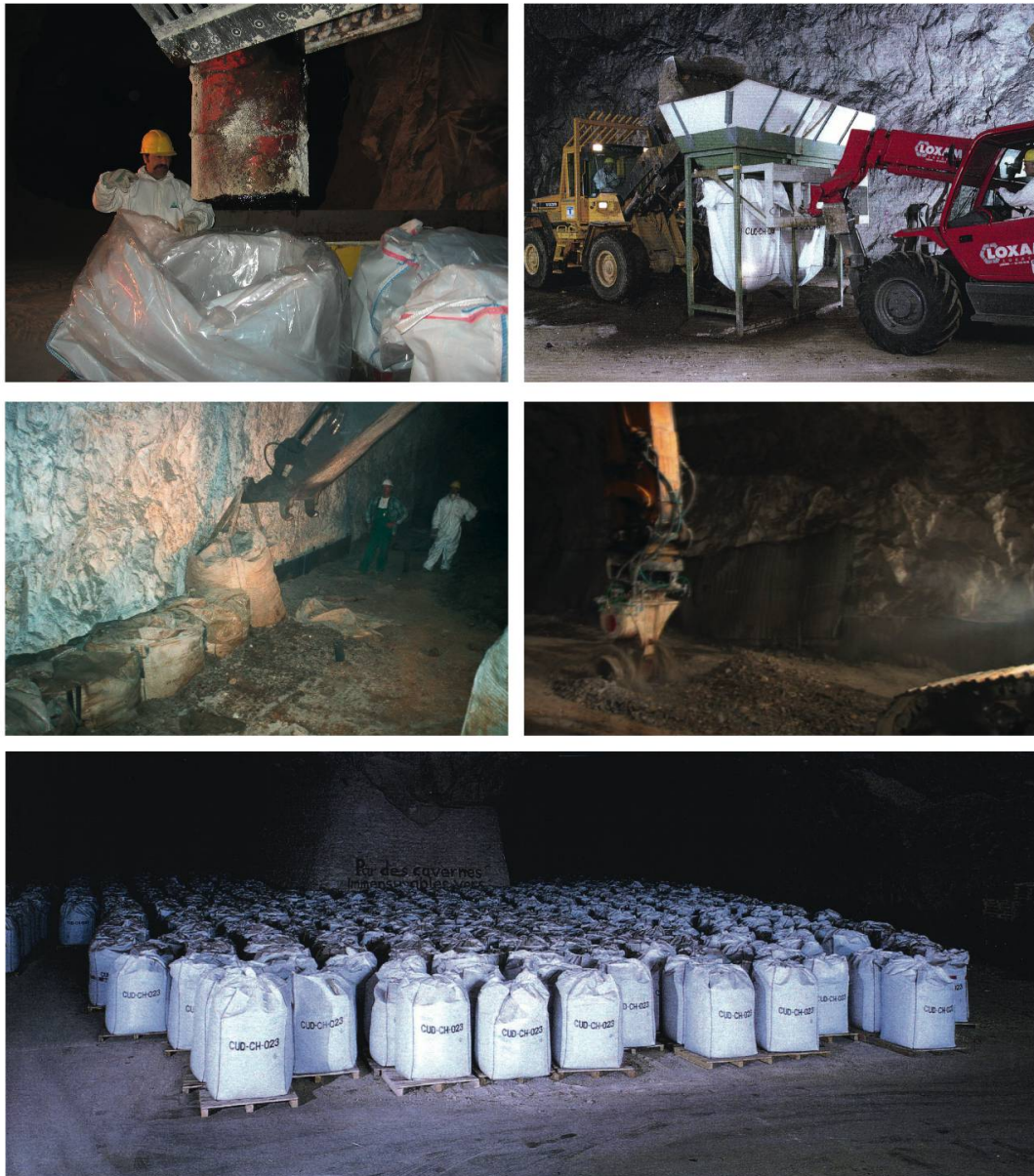
Fig. 19: Etapes d'assainissement : récupération de big-bags et de fûts remplis d'hydrocarbures, fraisage et ensachage des boues stabilisées au ciment et préparation de big-bags pour le transport en mine de sel.
