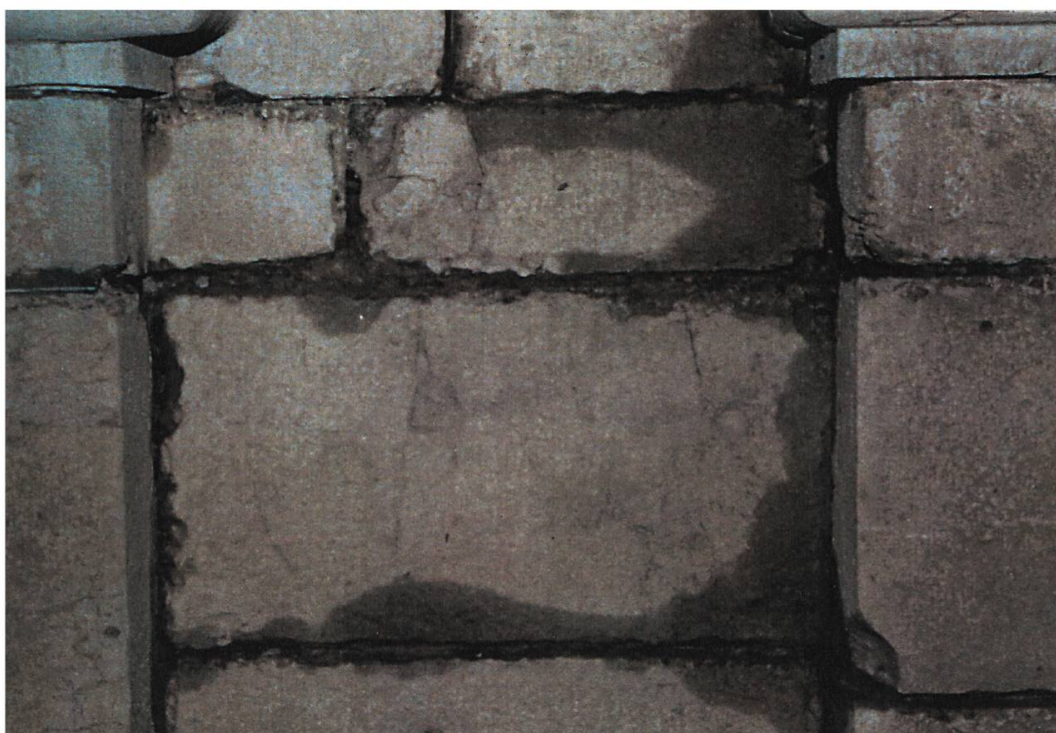
Fig. 9 : Eau coulant des joints ouverts (MHBE).
