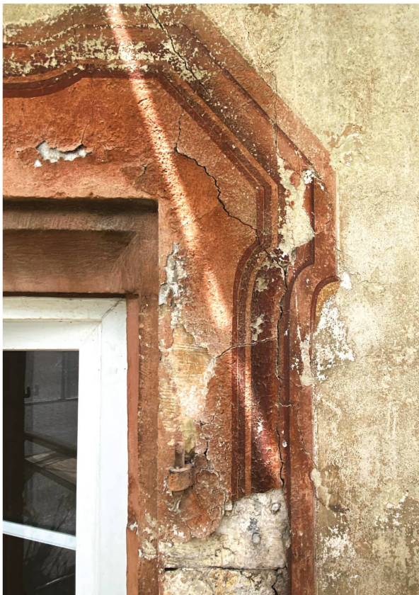
Ill. 11: Delémont, Café d'Espagne, détail d'un chambranle avant restauration.
