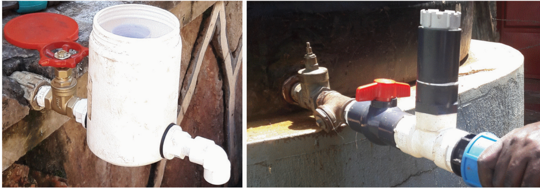
Fig. 3: Deux doseurs de chlore automatiques fabriqués à partir de matériaux locaux et bon marché.
