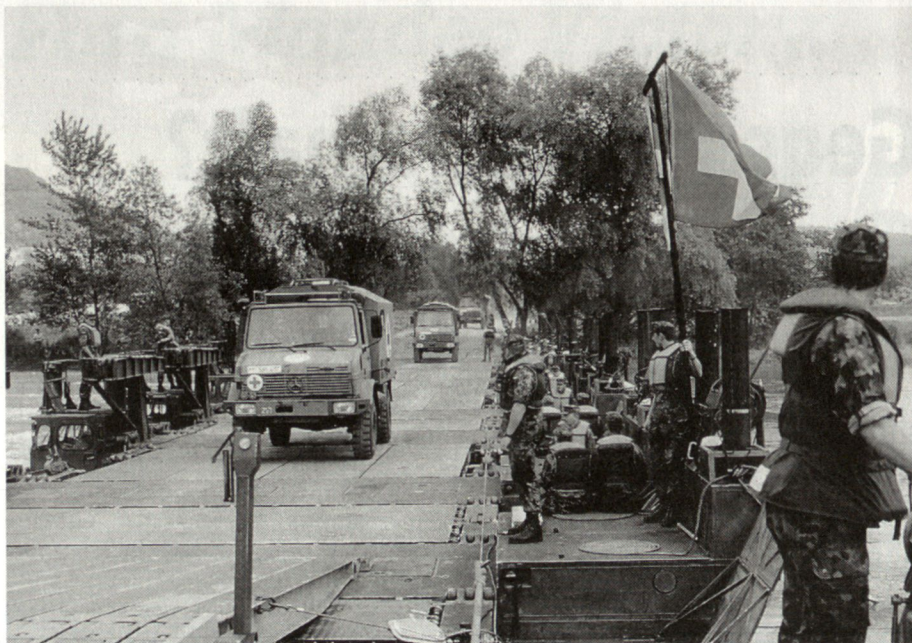
Am 27. Juni 1995 wurde von Angehörigen der deutschen Pionierlehrbrigade 60 und dem schweizerischen Pontonierbataillon 26 eine rund 150 m lange Brücke bei Zurzach über den Rhein erstellt. (Armee fotodienst)
