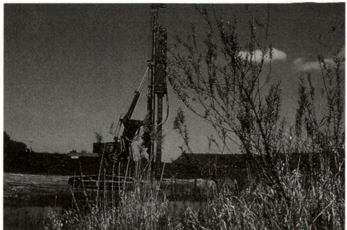
Abb. 3: Das Rammen von Pfählen (hier mit Ramme auf Raupenfahrzeug) als Voraussetzung zum Brückenbau. (Armee-fotodienst)
