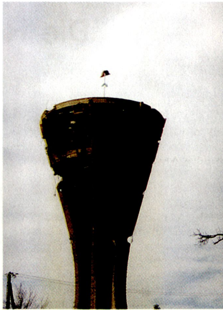
Bewusste Zerstörung der Infrastruktur, hier des Wasserturms.
