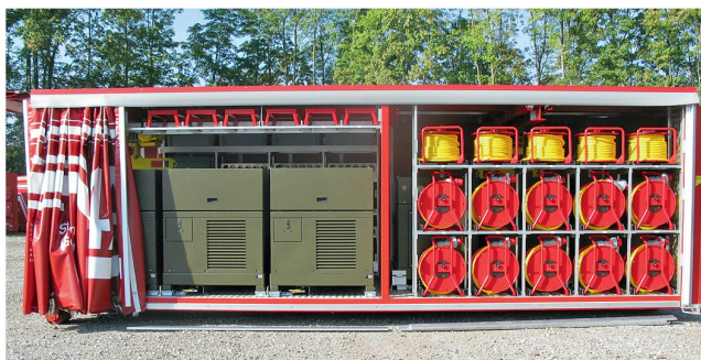
Wechselbehälter mit Stromerzeugung.
