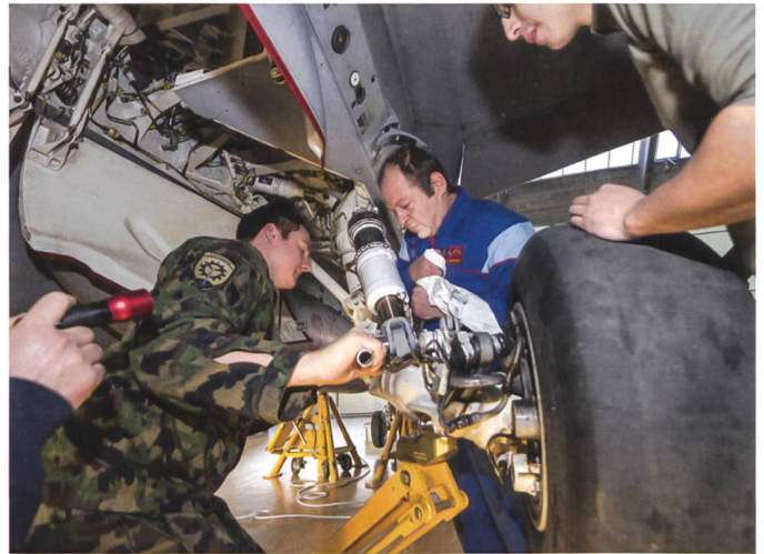
Miliz und Profis: In Sion unterstützen Flugzeugmechaniker AMHS (Aircraft Mechanic Hydraulic System) bei den Reparaturarbeiten eines F/A-18 Hornet.
