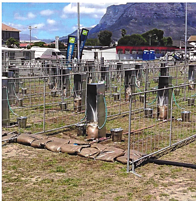
Wasserabgabestelle in Kapstadt.
