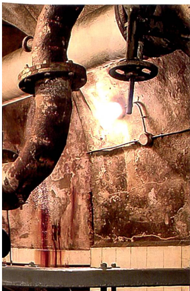
Abbildung unten: Artilleriewerk Michelsberg, Kraftwerk.
