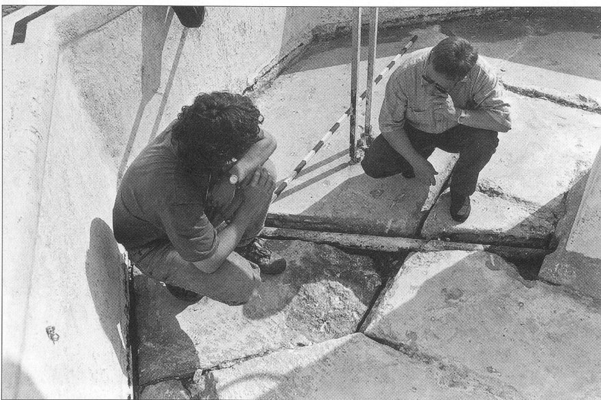
Abb. 5 Nach dem Entfernen des Betonbodens diskutiert der Denkmalpfleger mit dem Steinmetzen das weitere Vorgehen.
