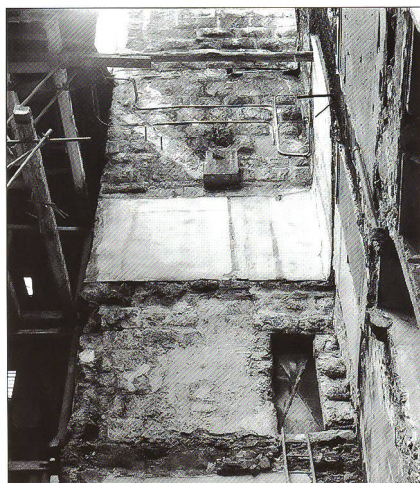
Abb. 5 Hocheingang im 2. Obergeschoss Südseite, Zustand vor der Zumauerung 1960 anlässlich des Neubaus des Hotels «Roter Turm». Gut erkennbar das aus gebossten Quadern sorgfältig geschichtete Türgewände und die mit Eisenblech beschlagene Tür.
