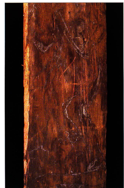
Abb. 20 Figürliche Darstellung an einem Binder der Dachkonstruktion von 1564.
