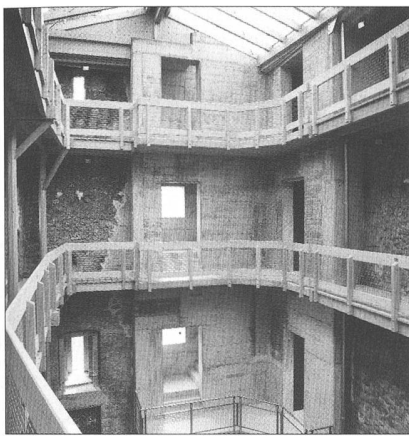
Abb. 5 Innenraum nach der Restaurierung mit neu aufgeführter Mauerecke, Holzgerüst mit Stabilisierungsringen (gleichzeitig Galerien) und Glasdach.
