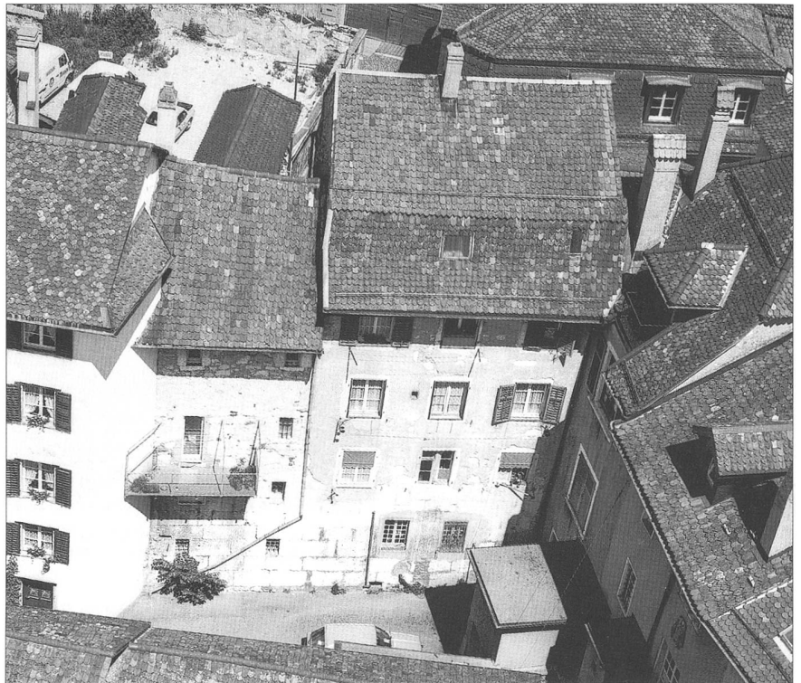
Abb. 1 Solothurn, Schmiedengasse 5, Rückfassade vor der Renovation.
