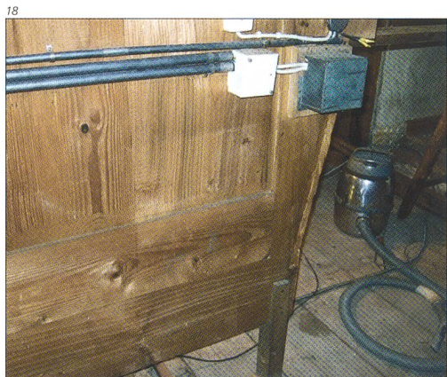
Abb. 18 Innenseite der Gehäusefront mit Ausschnitten, die schräg nach unten auf das Aussen- mass der Pedalklavatur verlaufen, darüber Elektro- installationen.
