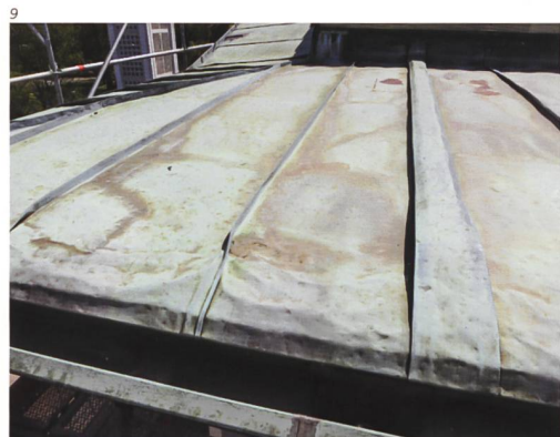
Abb. 9 Detail des Kirchendachs mit der schadhaften Kupferblecheindeckung. Foto 2017.
