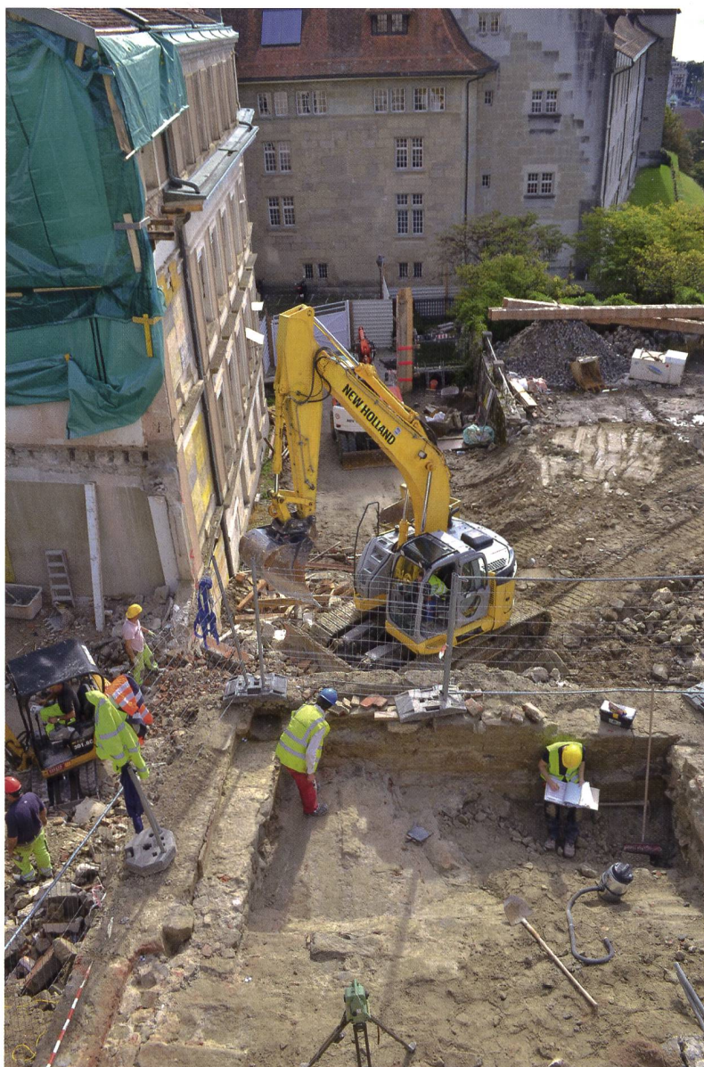
Fig. 6 Les archéologues sur le chantier de reconstruction du Parlement (photo Atelier d'archéologie médiévale).
