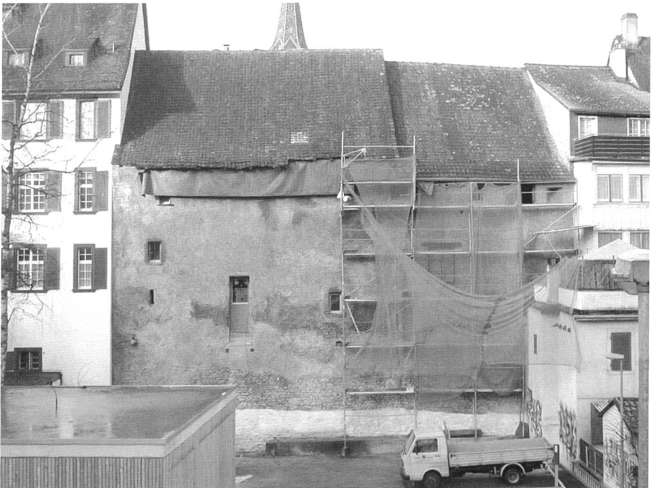
Abbildung 7: Der Stadtmauerabschnitt nach der Sanierung, von Anbauten befreit, während des Abbaus des Gerüsts.
