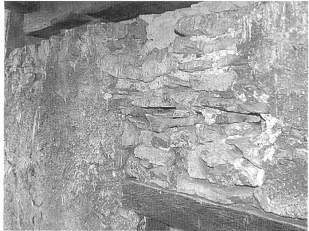
Abbildung 5: Fehlstelle im Verputz unterhalb der Mauerkrone über dem Fenster Nr. 2, dessen Holzgewände aus dem Jahr 1463 stammt. Die Fusspfette des Dachs ist bereits gesichert.
