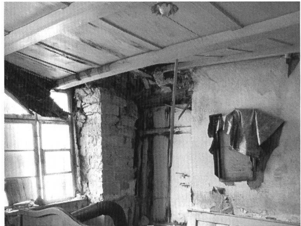
Eingebrochene Balkendecke in der Erweiterung von 1885. (Foto Daniel Scheidegger, Kilchberg).
