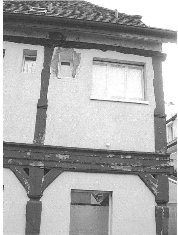
Vermauerte Laube ohne Geländer und Kopfbretter im Obergeschoss
