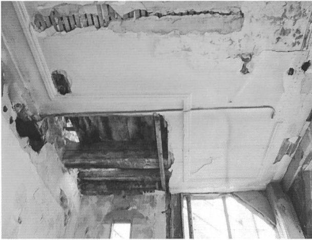
Gipsdecke im Erdgeschoss mit Fries, das bereits Rücksicht auf den Einbau des Aborts nimmt.
