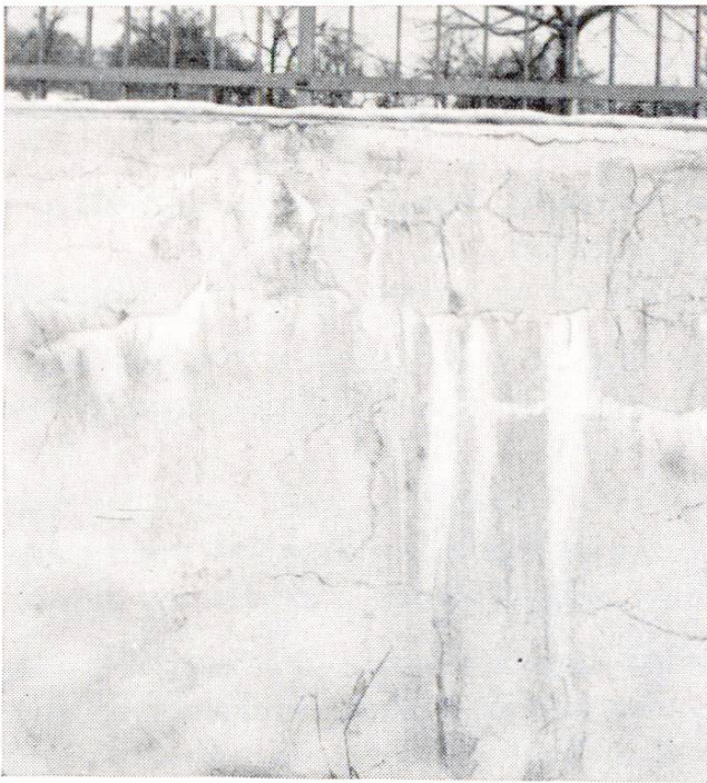
Fig. 2 Efflorescences calcaires sur le crépissage d'un mur de soutènement en béton (trainées blanches partant des fissures de l'enduit).
