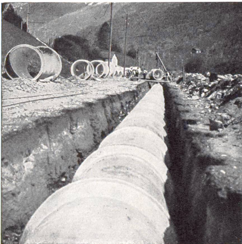
Fig. 1 Conduite Vianini Ø = 125 cm Installation de pompage Tremorgio.
