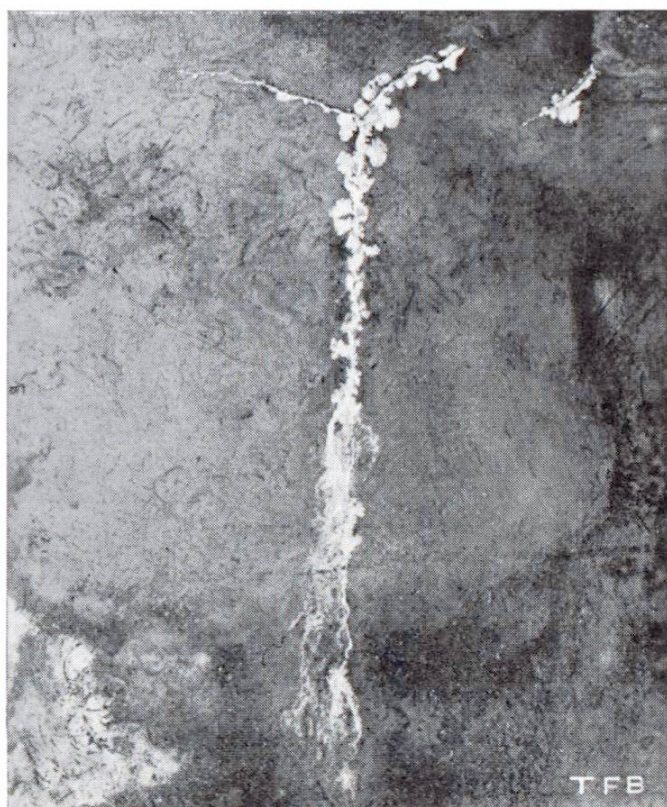
Fig. 2 Fissures d'affaissement dans les parois latérales d'un passage sous-voie. Après un certain temps, étanchement ou « guérison automatique » par colmatage.
