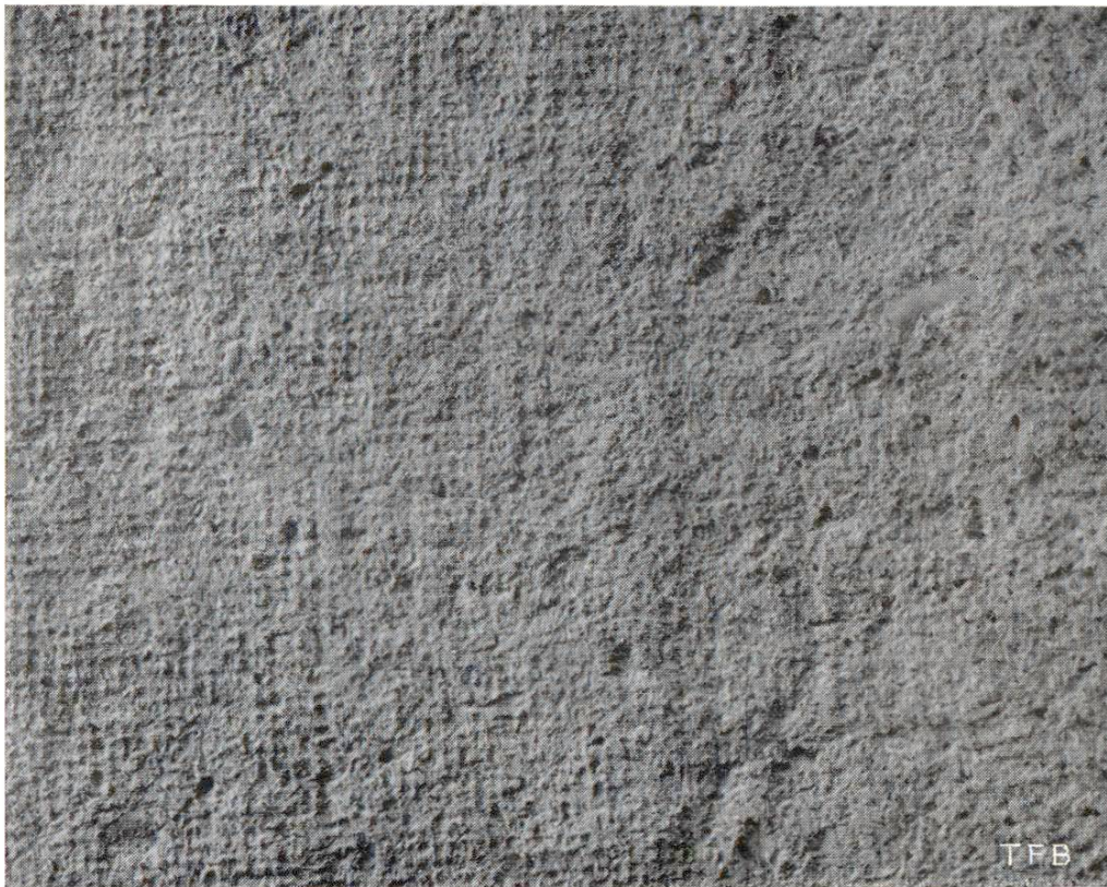
Fig. 3 Béton de parement obtenu en tendant dans le coffrage un tissu de jute bien mouillé
