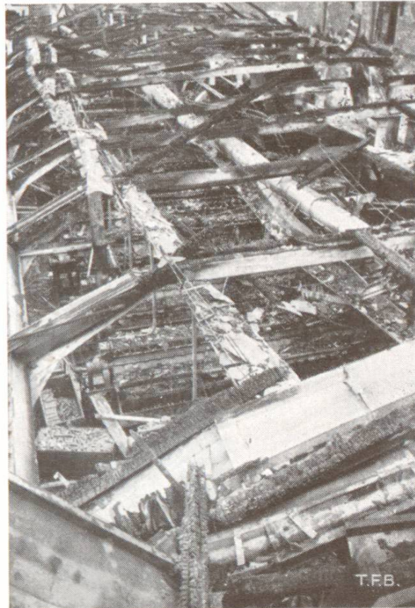
Fig. 8 L'incendie ne s'est étendu qu'aux combles. Le plancher en béton a empêché la propagation du feu au-dessous
