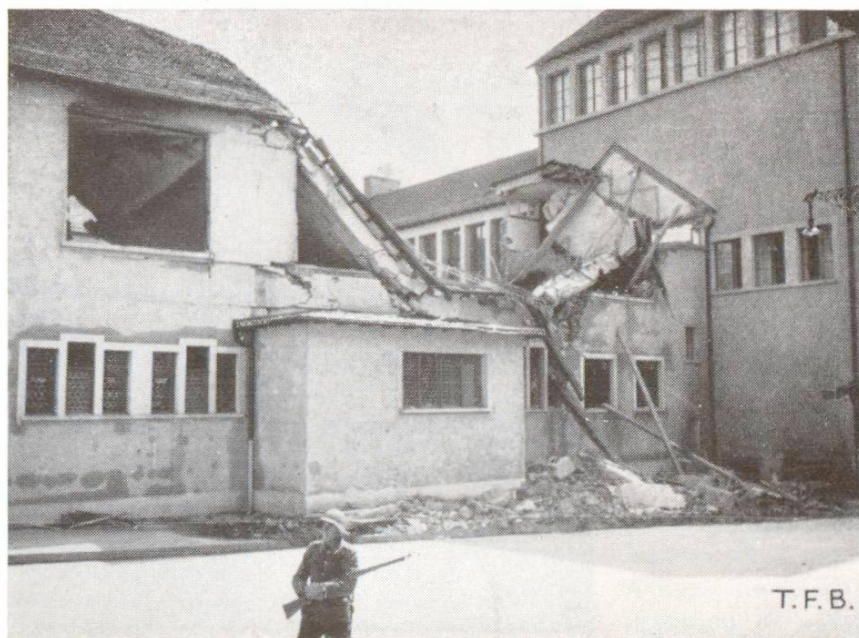
Fig. 6 Coup direct sur un plancher en béton armé avec hourdis. Eroulement du plancher par suite de la poussée laté- rale d'un mur d'ap- pui sous l'effet de l'onde de choc
