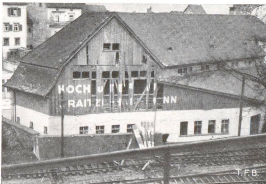
Fig. 4 Effet de la vague de dépression sur une construction légère
