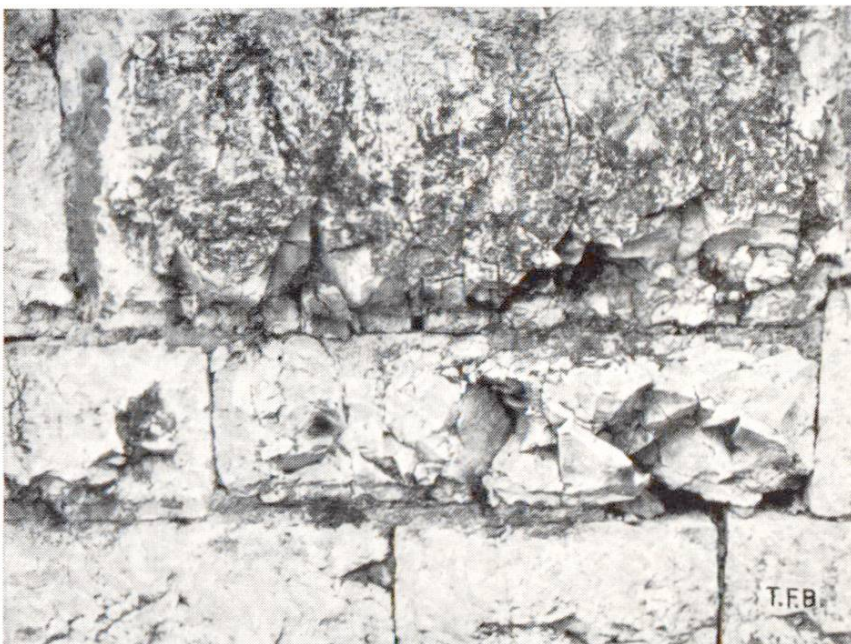
Fig. 3 Pierres calcaires fissurées désagrégées par le gel. Exemple d'une construction gélive
