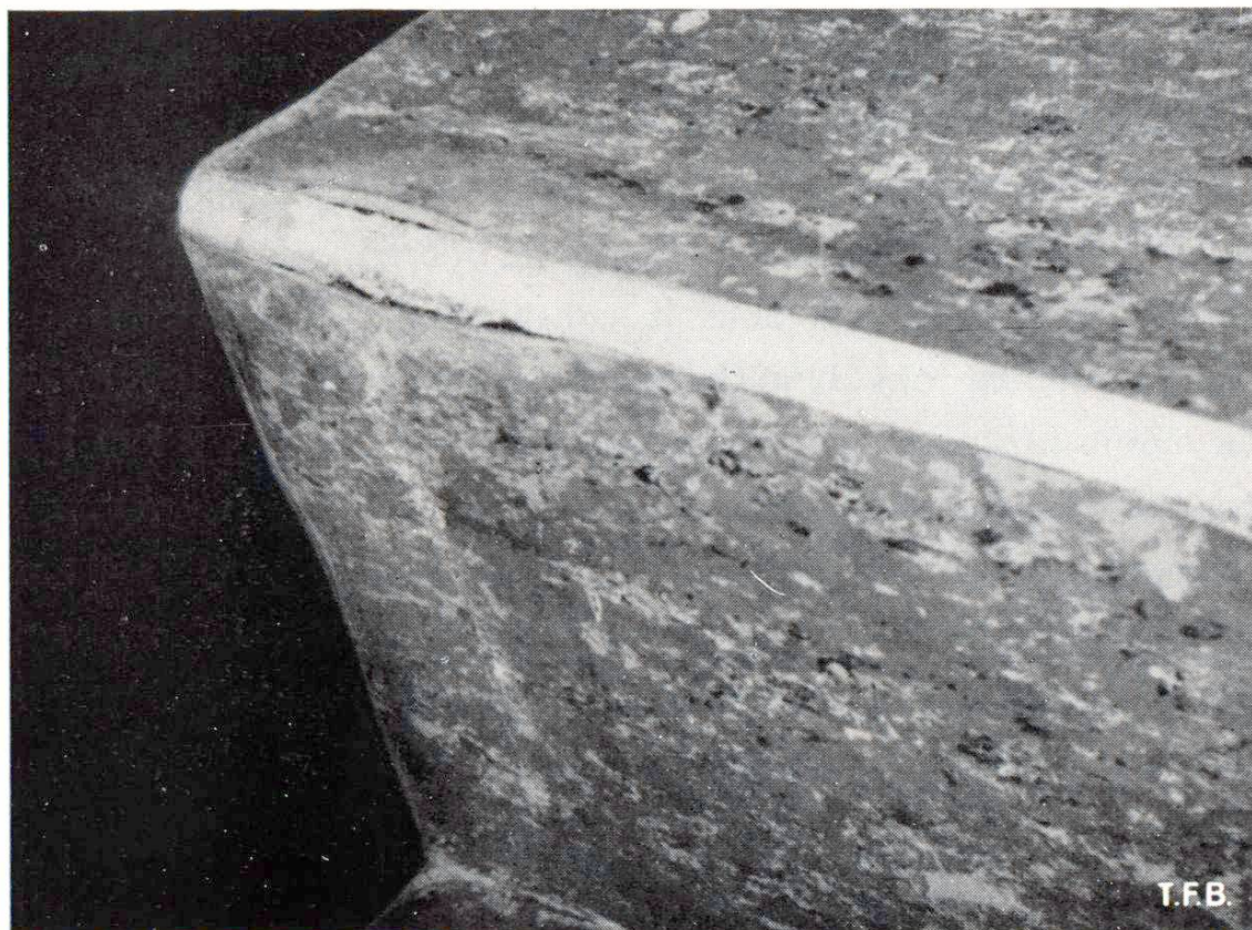
Fig. 1 Début de décomposition d'anticorodal. Cornière d'escalier en béton
