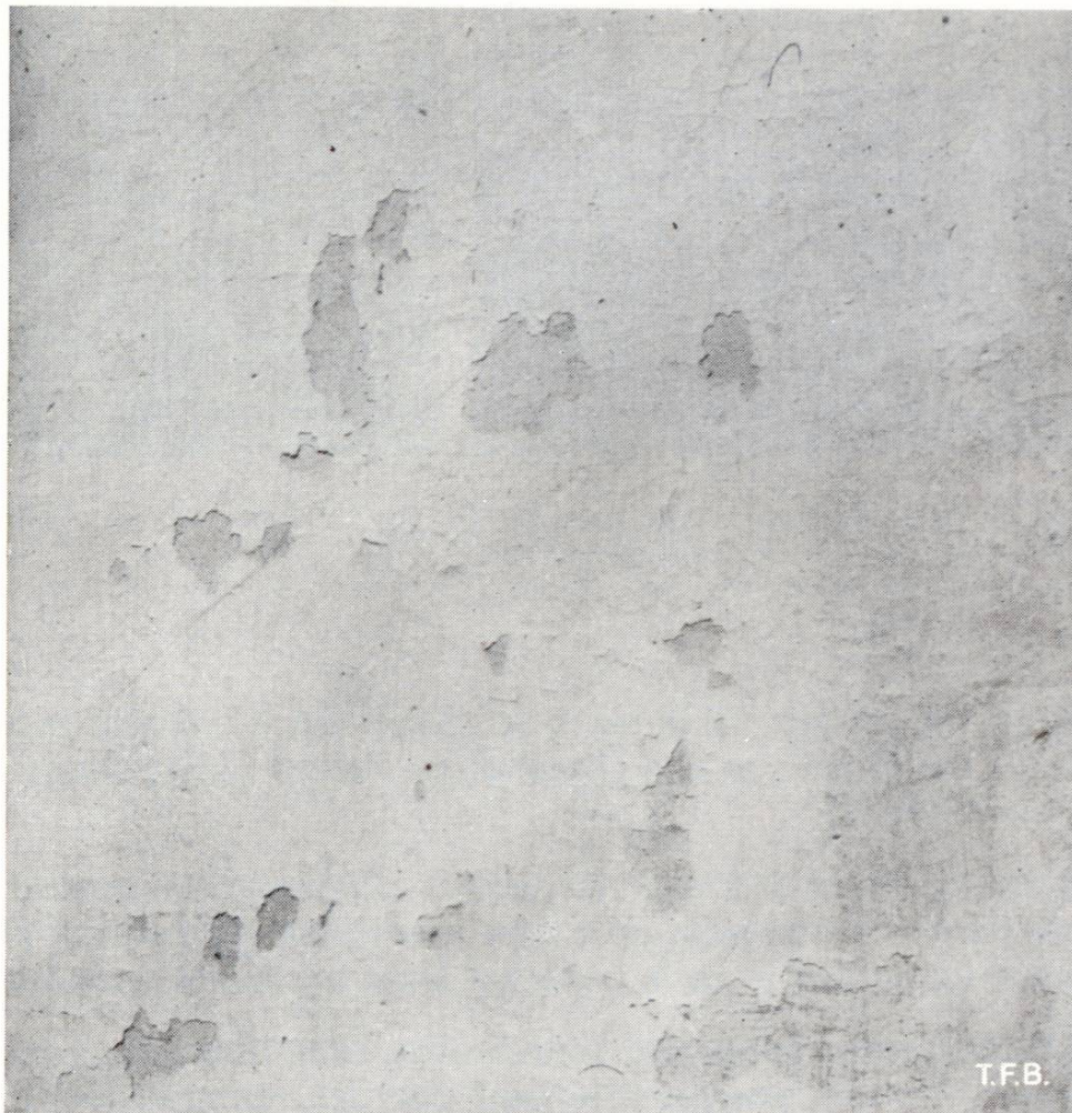
Fig. 3 Ecaillage d'une peinture de façade dû à une adjonction inappropriée au mortier
