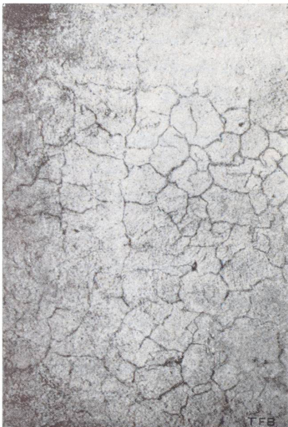
Fig. 2 Fissures de retrait sur un enduit préparé avec un excès de sable fin et qui, en outre, s'est desséché prématurément
